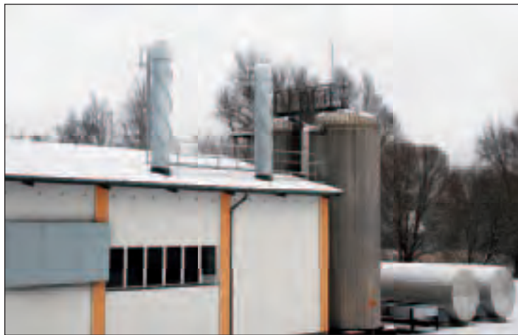
Das Herz der Luckenwalder Fernwärmeversorgung: das BHKW am Standort Kirchhofsweg.
